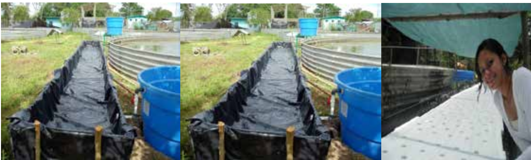
Figura 2. Construcción del diseño propuesto para reutilizar el agua en el tanque piscícola. Fuente: foto de García, M. D (2012).
